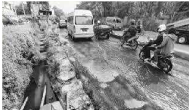
Gambar 4.1. Perbaikan Saluran Air yang belum tuntas
