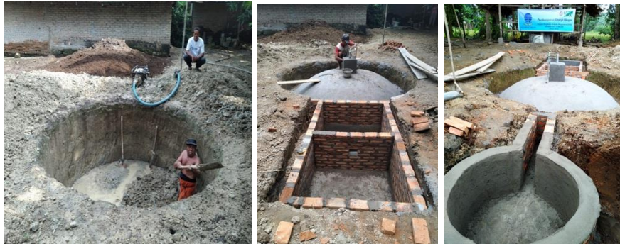
Gambar 1. Proses pembangunan reaktor/digester biogas di dusun 3 Desa kolam yang dibangun oleh warga lokal yang telah dilatih pada program PkM Nasional UT Medan FST tahun 2019.
